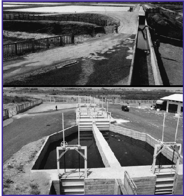
La station d'épuration de l'eau de Bujumbura
